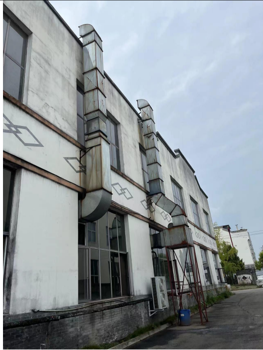
炒料车间油烟净化器及排气筒
