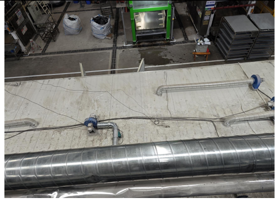
烘干废气收集管道
